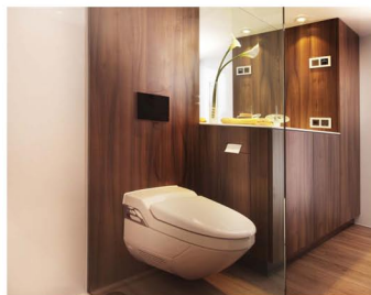
Ein hochmodernes Dusch-WC und Schränke mit reichlich Stauraum machen den Komfort perfekt. Fotos: Geiger
